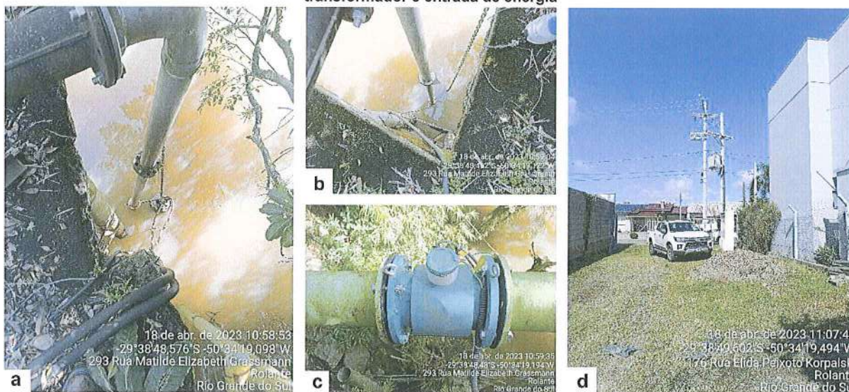
Figura 1: Captação de água bruta: a) Bomba operativa; b) Bomba reserva; c) Macromedidor instalado; d) Novo transformador e entrada de energia
