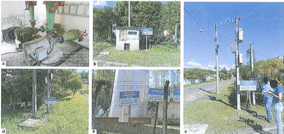
Figura 11: Vista das Estação de Bombeamento de Água Tratada fiscalizadas: a) EBAT-1; b) EBA-1 (com inversor de frequência); c) EBA-2; d) EBA-3 e e) EBA-4.
