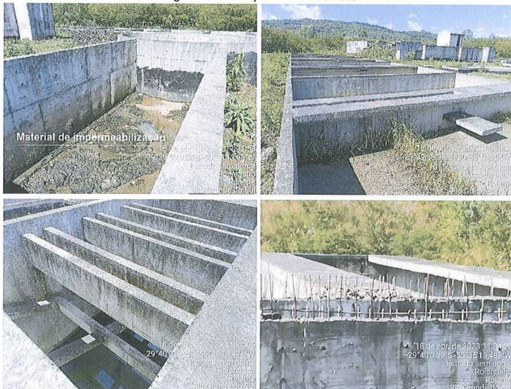
Figura 16: Obras paralisadas da ETE.
