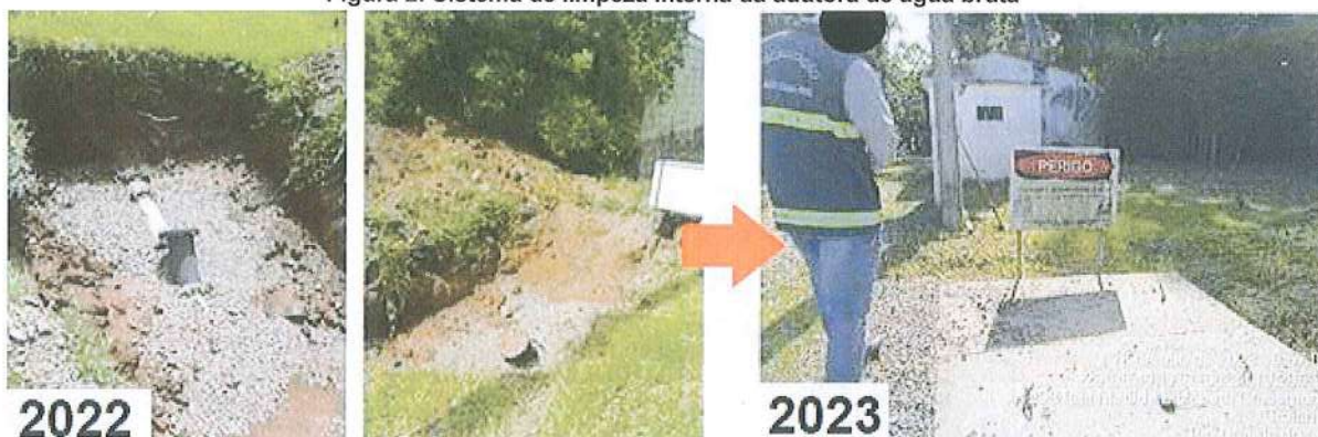
Figura 2: Sistema de limpeza interna da adutora de água bruta
