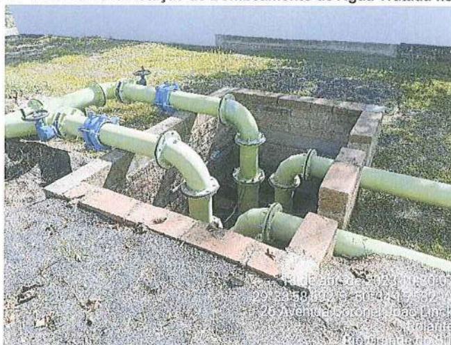
Figura 12: Vista da nova Estação de Bombeamento de Água Tratada fiscalizada
