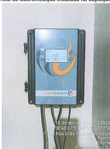
Figura 3: Vista da Macromedição instalada na Captação de Rolante
