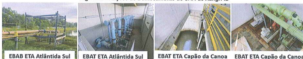
Figura 6: Estações de Bombeamento do SAA de Xangri-lá
