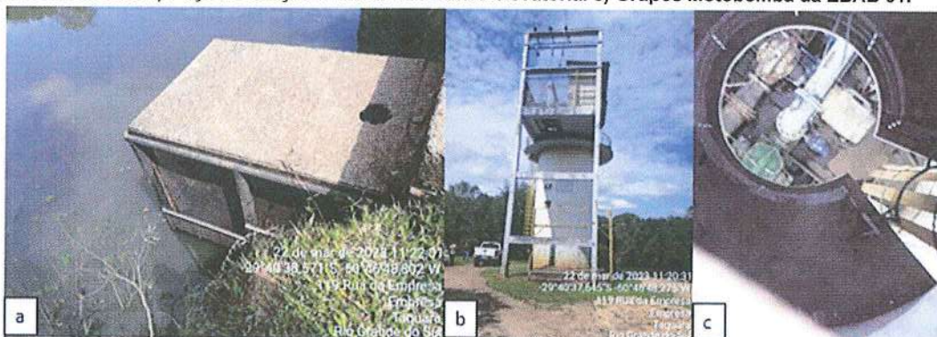
Figura 5: Estrutura de Captação de Água Bruta do município de Taquara: a) Local onde as bombas submersíveis se encontram instaladas. b) Poço de sucção onde se encontra a elevatória. c) Grupos Motobomba da EBAB 01.
