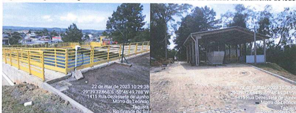
Figura 11: Registros fotográficos das obras da fase de conclusão da unidade de tratamento de lodo.
