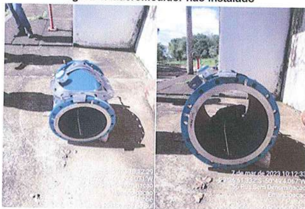
Figura 4: Macromedidor não instalado
