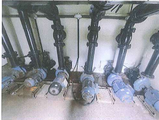
Figura 7: Bombas para alimentação da rede de distribuição.
