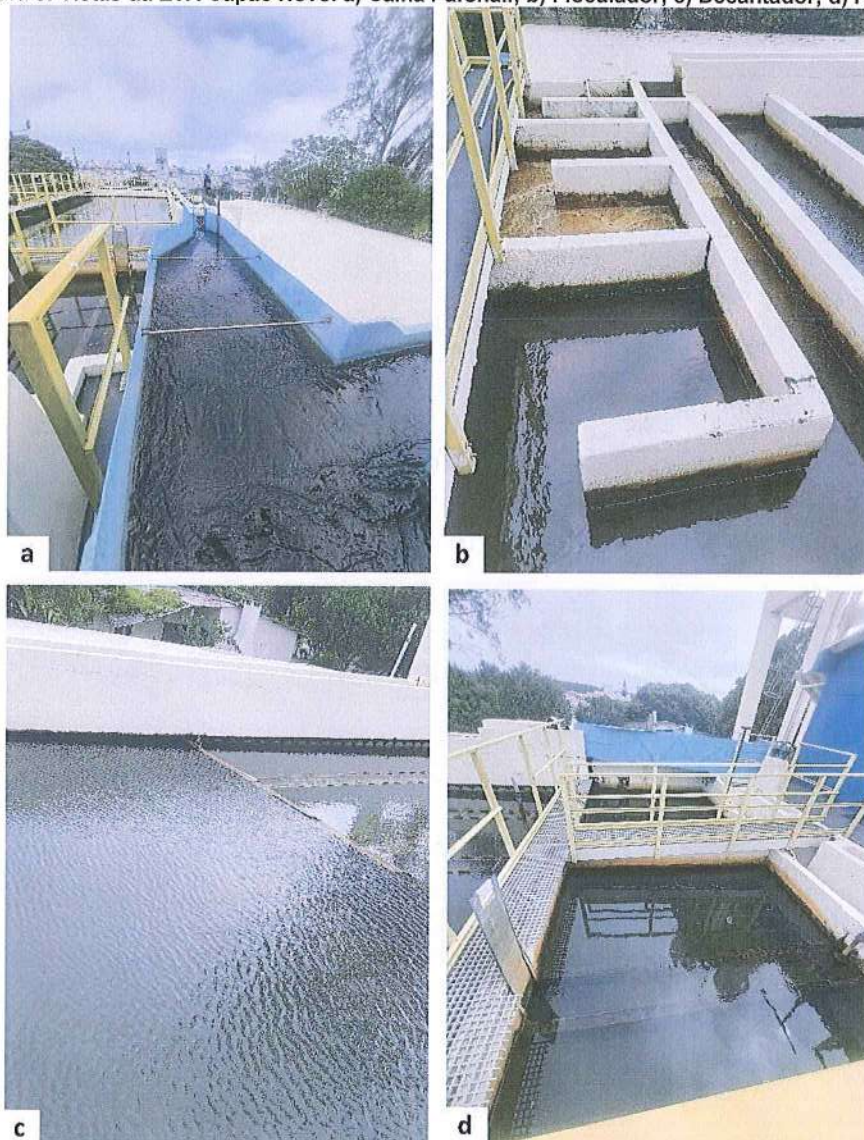
Figura 5: Vistas da ETA Capão Novo. a) Calha Parshall; b) Floculador; c) Decantador; d) Filtros.
