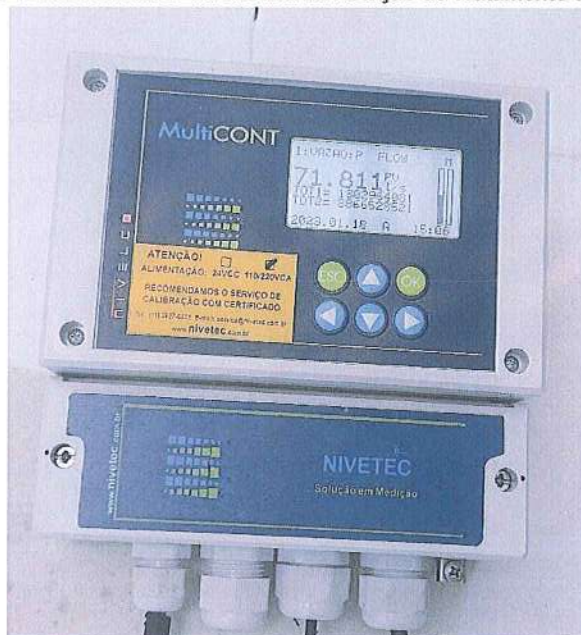
Figura 4: Macromedidor na entrada da Estação de Tratamento de água.
