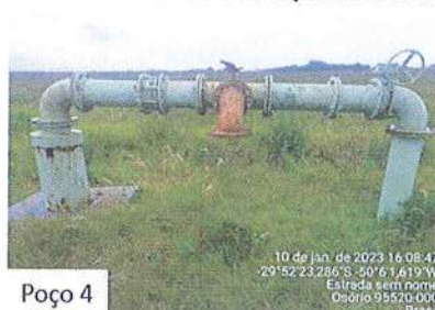
Figura 1: Vista do poço desativado localizado bem próximo a captação do Rio Tramandaí.
