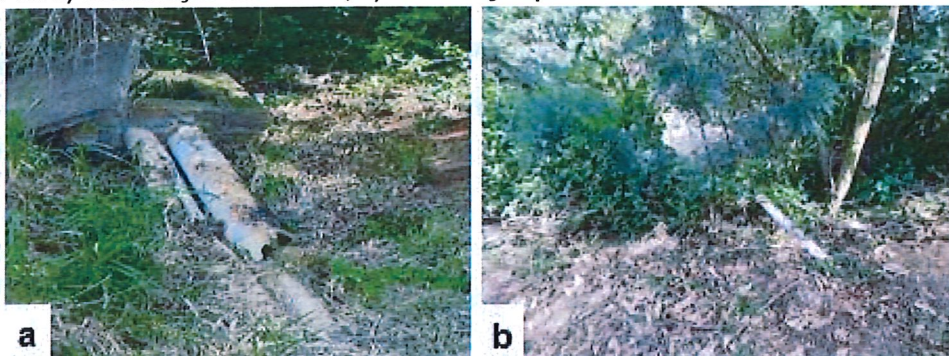
Figura 10: a) Canalização danificada; b) Canalização por onde sai o chorume do aterro sanitário
