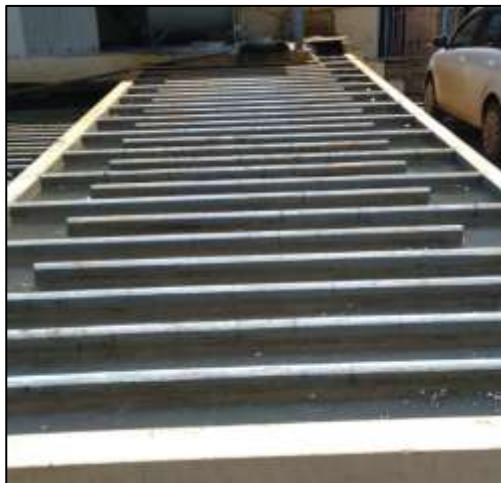
Figura 03: NC 03 – Floculador após a limpeza.
