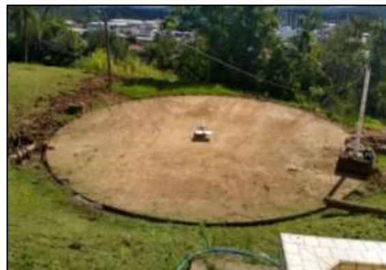
Figura 06: NC 13 e 17 – Área junto ao reservatório R1 limpa e com vala de drenagem instalada.
