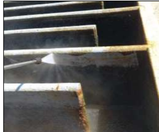
Figura 02: NC 03 - Floculador em processo de limpeza.
