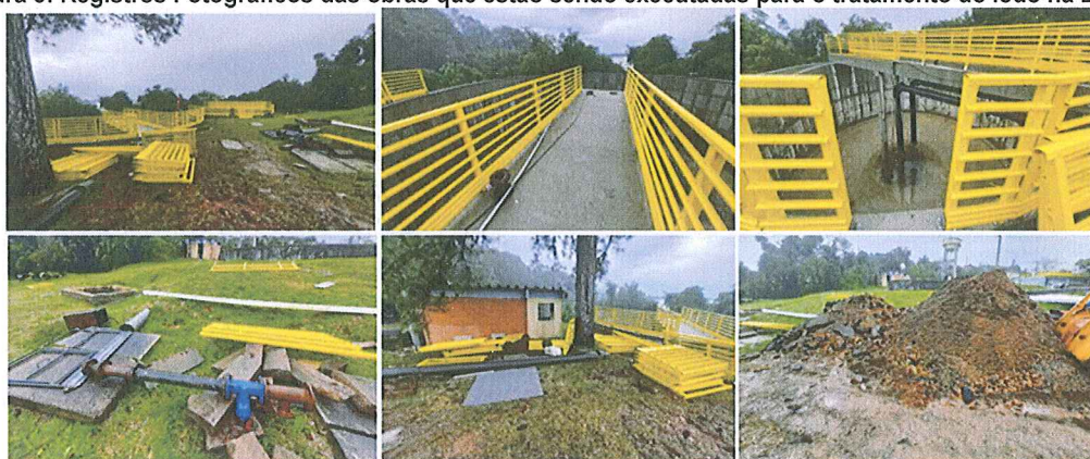
Figura 3: Registros Fotográficos das obras que estão sendo executadas para o tratamento do lodo na ETA 1.
