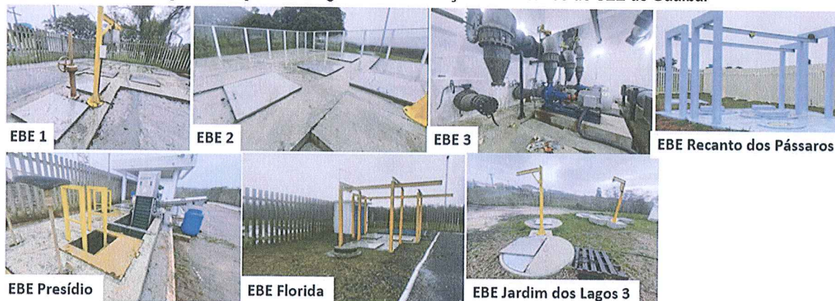
Figura 7: Registros fotográficos das estações elevatórias do SEE de Guaíba.
