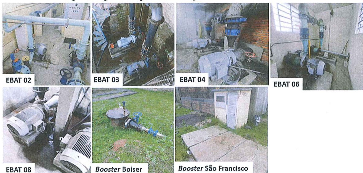
Figura 6: Registros fotográficos das estações elevatórias do SAA de Guaíba.
