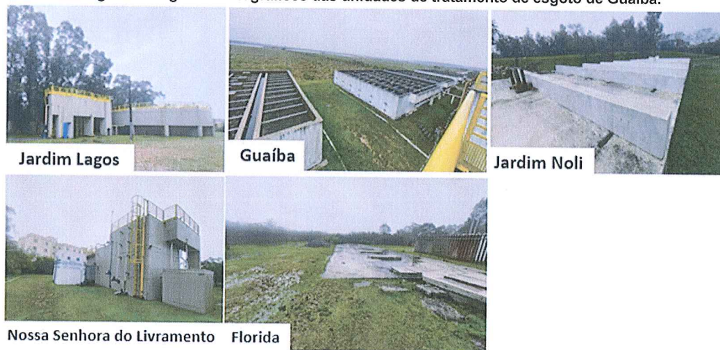
Figura 8: Registros fotográficos das unidades de tratamento de esgoto de Guaíba.
