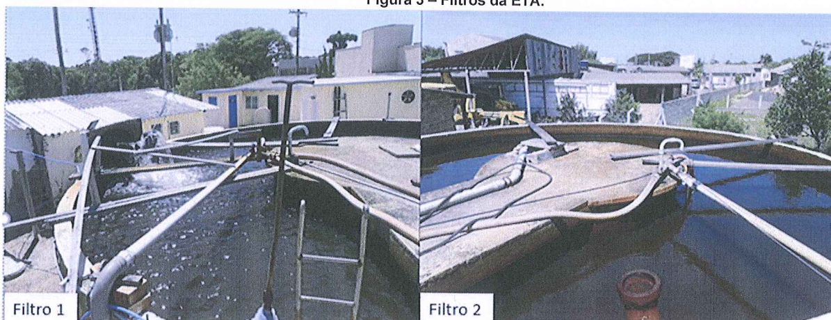
Figura 3 – Filtros da ETA.
