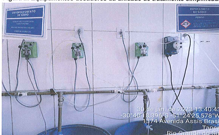
Figura 2: Equipamentos dosadores da unidade de tratamento simplificada
