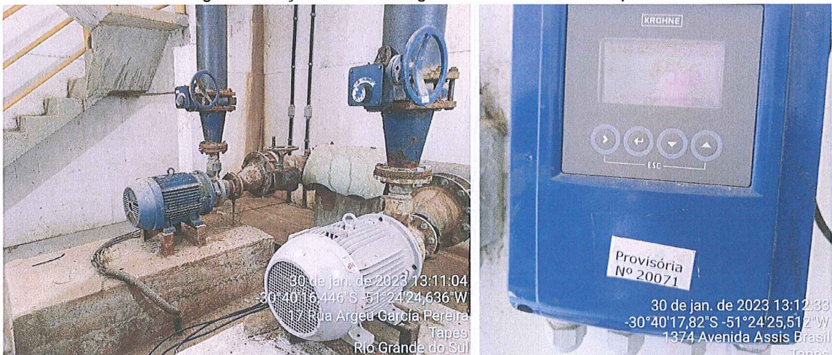
Figura 5: Estação elevatória de água tratada fiscalizada em Tapes
