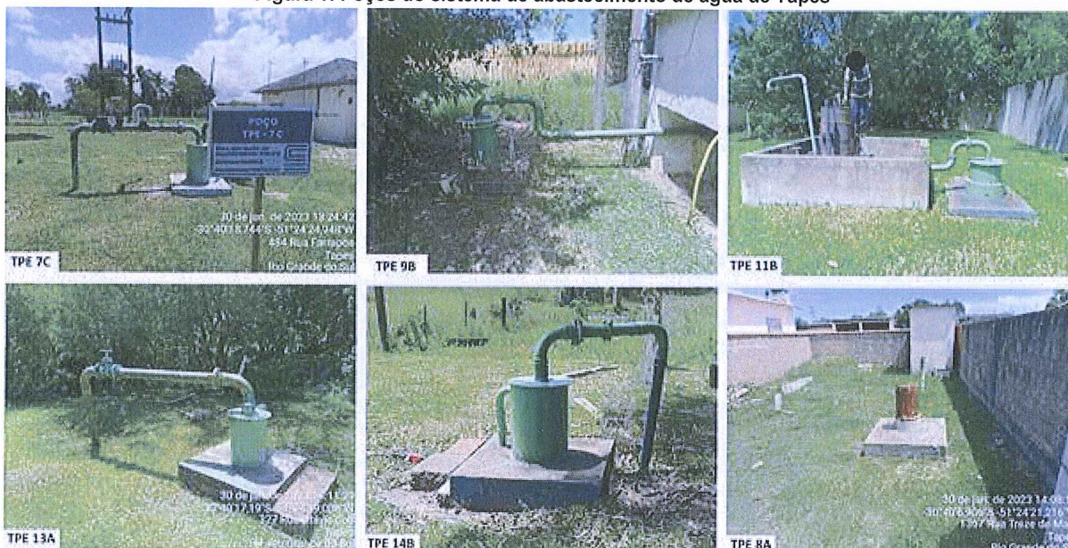
Figura 1: Poços do sistema de abastecimento de água de Tapes
