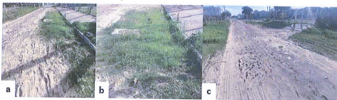
Figura 12 – Registros fotográficos da Rua Padre Réus: a) Vista de ausência de calçamento; b) Vista da presença de vegetação; c) deformidades na pavimentação da rua
