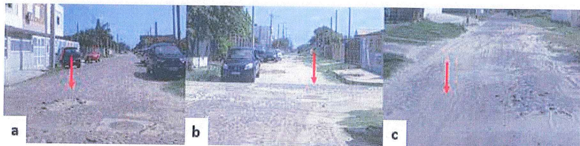
Figura 5 – Registros fotográficos da Rua Padre Réus: a) Vista das deformidades no calçamento; b) Vista do pavimento não nivelado na intersecção; c) Vista da ausência de calçamento
