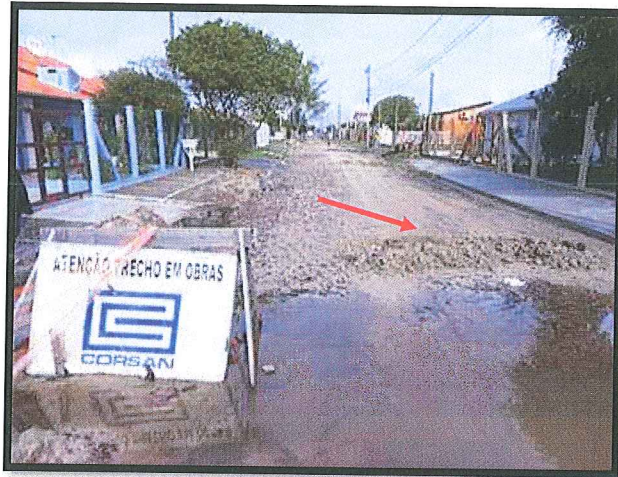
Figura 4: Registro fotográfico da interrupção de tráfego na via
