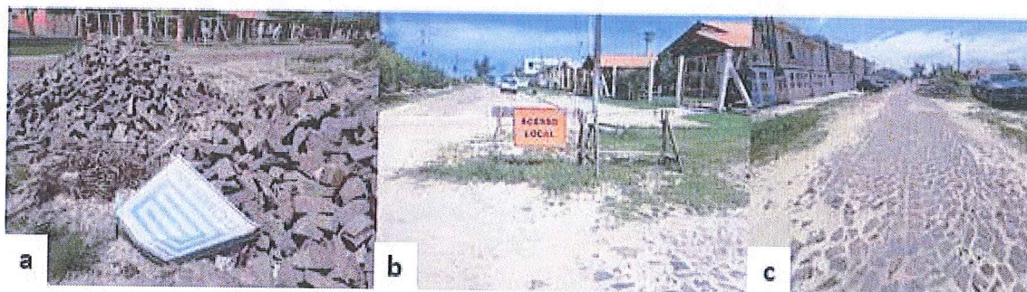
Figura 9 – Registros fotográficos da Av. Deputado Oswaldo Bastos: a) Vista de resíduos da construção civil e outros materiais dispostos no passeio público; b) Vista de estruturas sinalizando que a via estava em obras; c) Vista em processo de calçamento
