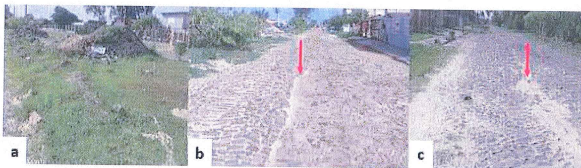
Figura 11 – Registros fotográficos da Av. Deputado Oswaldo Bastos: a) Vista de resíduos de obra depositados no passeio público; b) Vista de irregularidades no pavimento; c) Vista de irregularidades no pavimento
