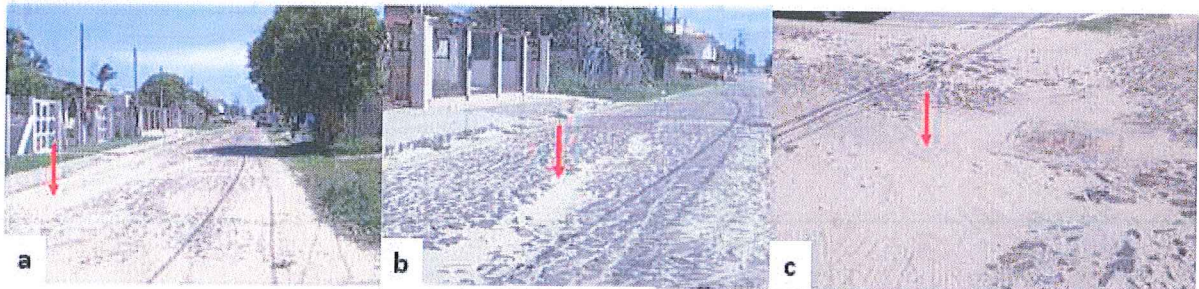
Figura 3 – Registros fotográficos da Rua Santos Dumont. a) Vista do calçamento irregular; b) Vista do assentamento inadequado; c) Vista da intersecção entre as vias apresentando desnivelamentos
