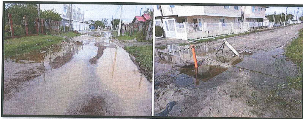
Figura 5: Registros fotográficos das vias alagadas
