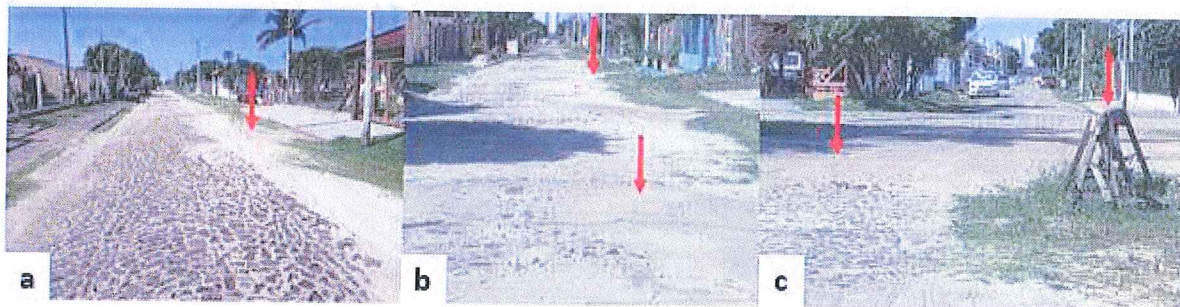
Figura 6 – Registros fotográficos da rua Castro Alves: a) Vista da ausência de calçamento em pontos próximos às calçadas; b) Vista de deformidades ao longo da via; c) Vista das vias não niveladas na intersecção e da estrutura sinalizando a execução de obras
