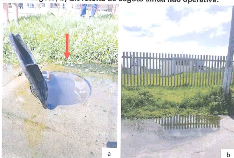
Figura 9 - Registro fotográfico da ocorrência de vazamento de esgoto na via pública: a) Ponto de extravasamento de esgoto; b) Elevatória de esgoto ainda não operativa.
