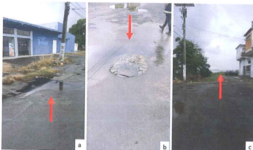
Figura 11 - Registro fotográfico da ocorrência de vazamento de esgoto na via pública: a) Ponto de extravasamento de esgoto; b) Ponto de infiltração do esgoto na rede de drenagem; c) Rio Tramandaí ao fundo.
