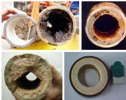
Figura 10 – Exemplos de perda de seção nas adutoras
