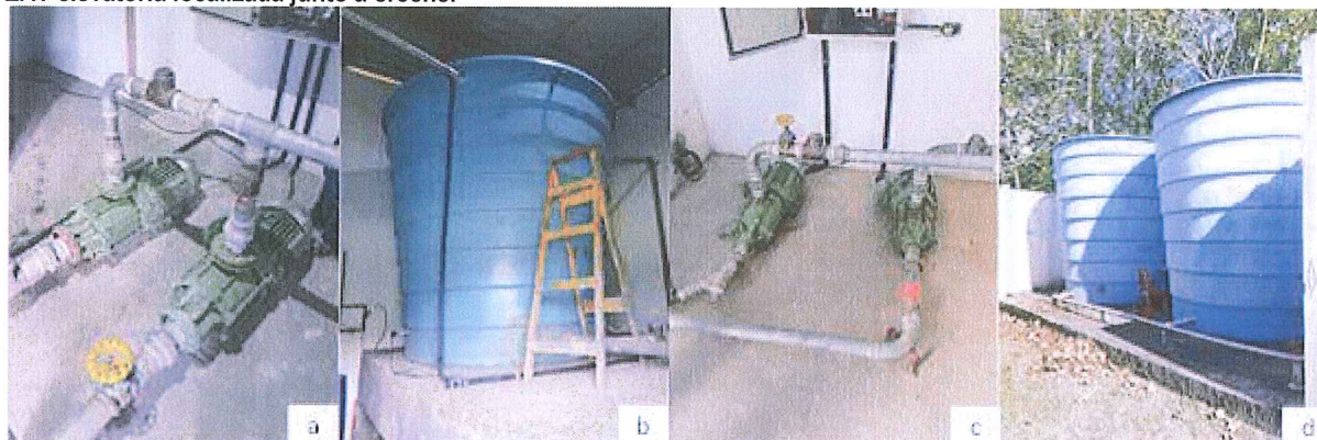
Figura 9: Registro fotográfico das EAT: a) Vista da elevatória localizada junto ao poço P1; b) Vista do tanque de contato da EAT localizada junto ao poço P1; c) Vista da elevatória localizada junto à creche; d) Vista do tanque de contato da EAT elevatória localizada junto à creche.
