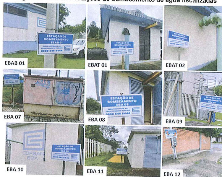
Figura 7: Vista das estações de bombeamento de água fiscalizadas
