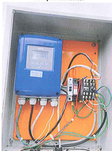
Figura 10: Equipamento responsável pela medição da água exportada para igrejinha, o qual não estava funcionando adequadamente.
