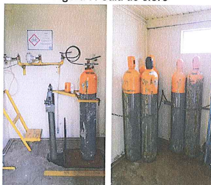
Figura 7: Sala de cloro
