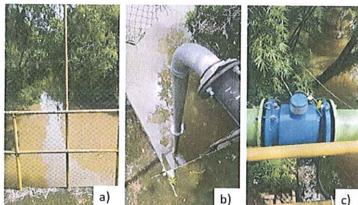
Figura 1: Captação de água bruta: a) Vista do corpo hídrico; b) Vista do local onde a bomba está posicionada; c) Vista do macromedidor instalado;
