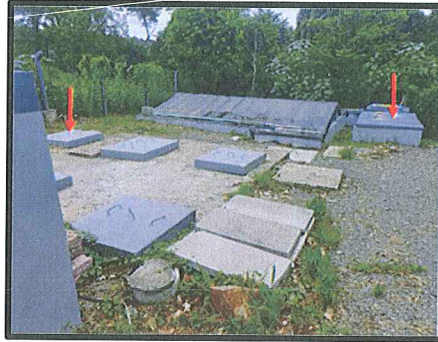
Figura 12: Vista da localização da bomba de recirculação do lodo e dos tanques sépticos
