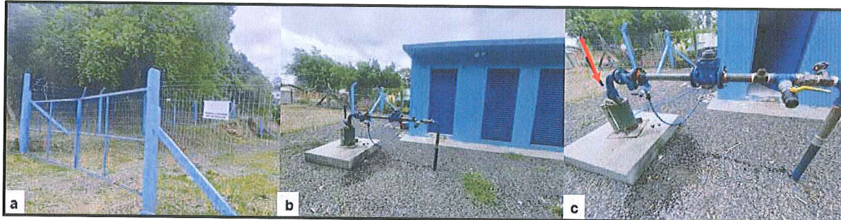
Figura 6: a) Vista do cercamento do poço b) Vista da casa de química e energia elétrica c) Vista do ponto de captação do Poço 56 localizado na Rua Portela, n. 45
