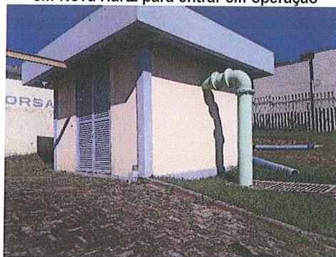
Figura 1: Estação de Bombeamento de Água localizada em Parobé, já pronta, aguardando a finalização do reservatório em Nova Hartz para entrar em operação
