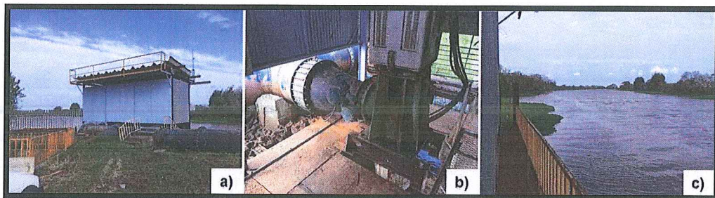
Figura 1: Sistema de Captação de Água Bruta. a) Vista da casa de bombas; b) Vista da bomba de captação; c) Vista do manancial do Rio Jacuí
