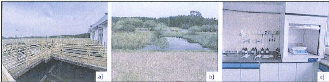
Figura 8: Vistas da ETA Atlântida Sul. a) Vista bloco hidráulico da ETA; b) Vista do sistema de tratamento do lodo; c) Vista do laboratório da ETA.
