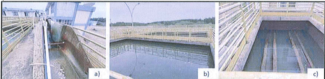
Figura 9: Vistas da ETA Atlântida Sul. a) Vista da Calha Parshall; b) Vista do decantador; c) Vista de um dos filtros da ETA;
