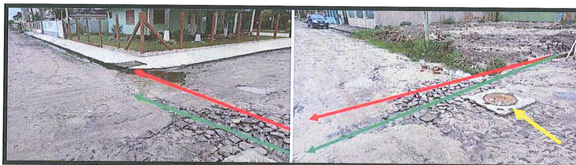
Figura 22 – Desalinhamento dos desnível laterais entre as vias
