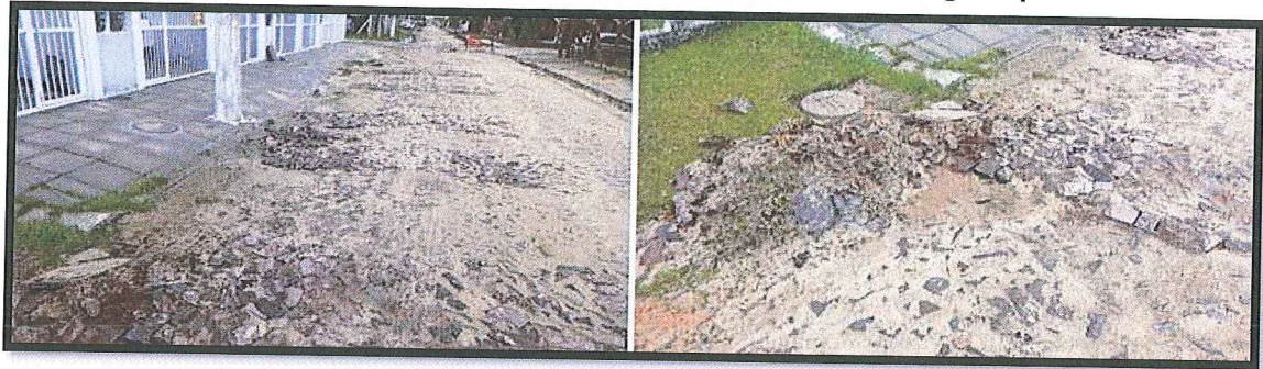
Figura 23 – Falta de assentamento do calçamento em alguns pontos
