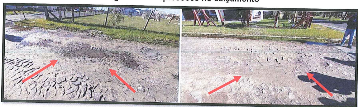
Figura 28 – Depressões no calçamento
