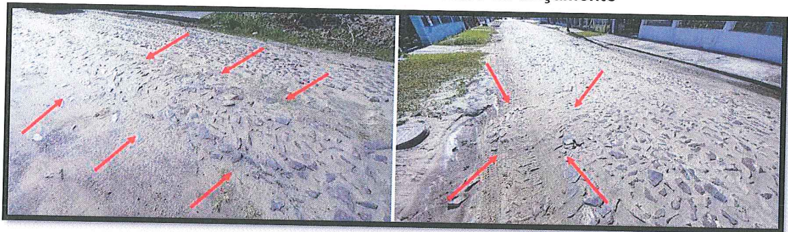
Figura 27 – Pontos sobressalentes no calçamento
