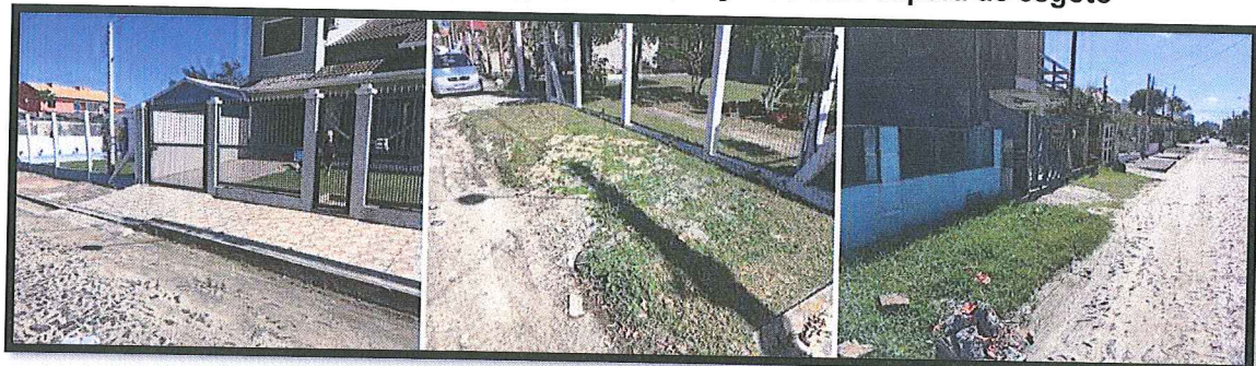
Figura 13: Registros fotográficos de calçados sem espera de esgoto
