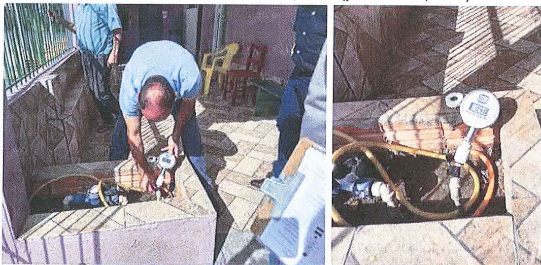
Figura 11: Rua Doze de Novembro, n. 162 (pressão de 9,6 mca)
