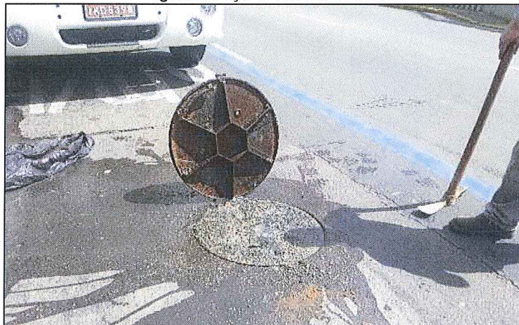
Figura 2: Poço de visita obstruído
