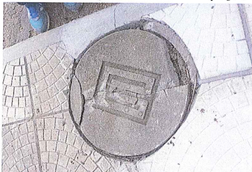
Figura 2: Tampa da caixa de inspeção
