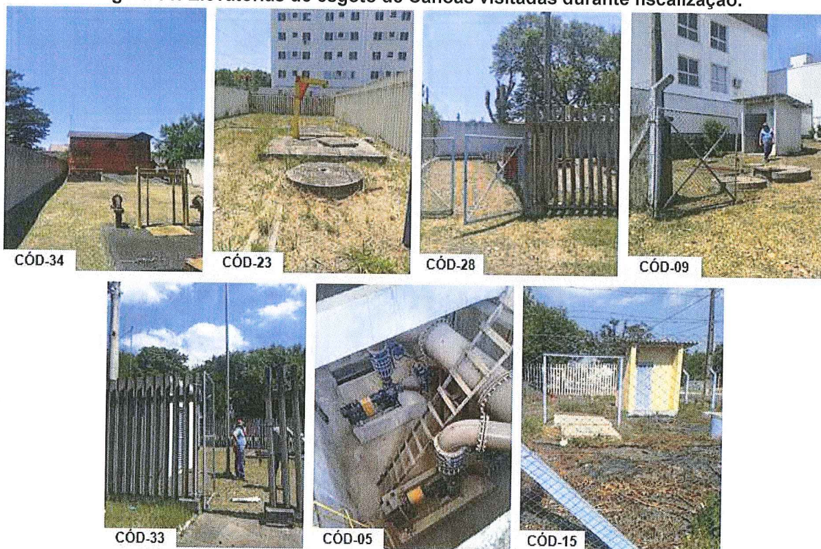
Figura 01: Elevatórias de esgoto de Canoas visitadas durante fiscalização.
