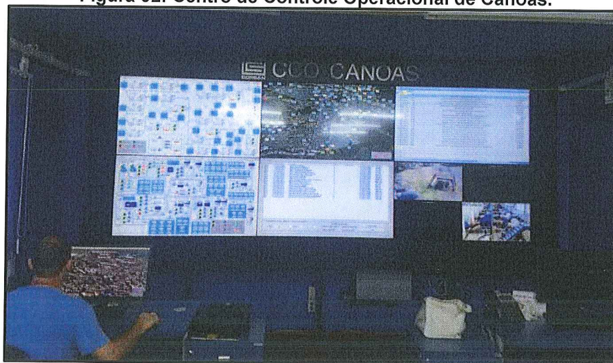
Figura 02: Centro de Controle Operacional de Canoas.
