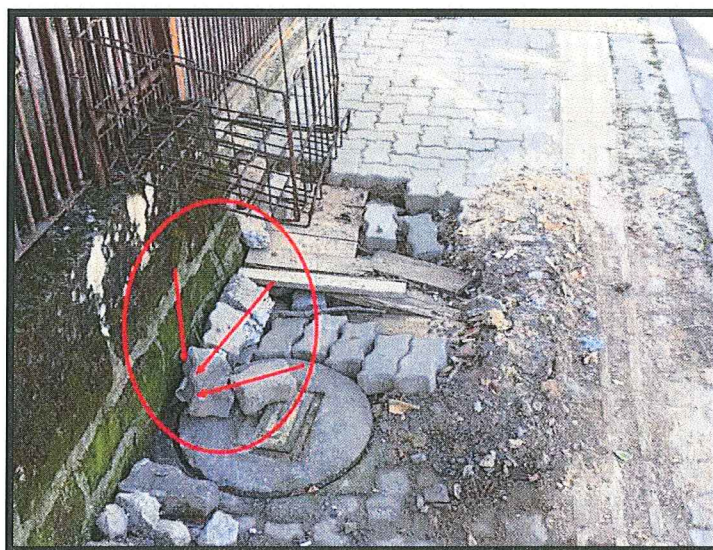
Figura 4: Ponto da tubulação aberta junto a tampa da caixa de passagem.
