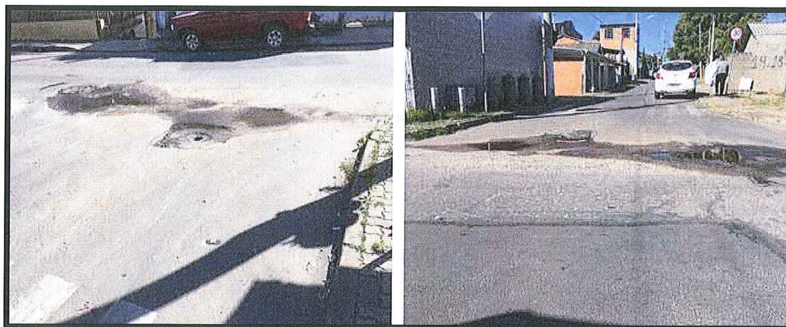
Figura 8: Vista do acúmulo de água.
