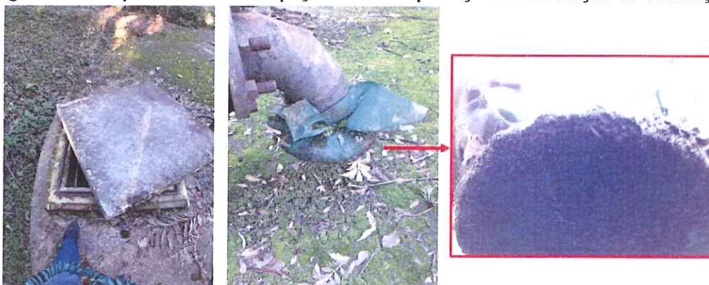
Figura 12: Tampa da caixa de inspeção e tela de proteção da tubulação de ventilação
