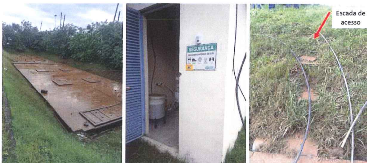
Figura 16: ETE Loteamento Cohab
