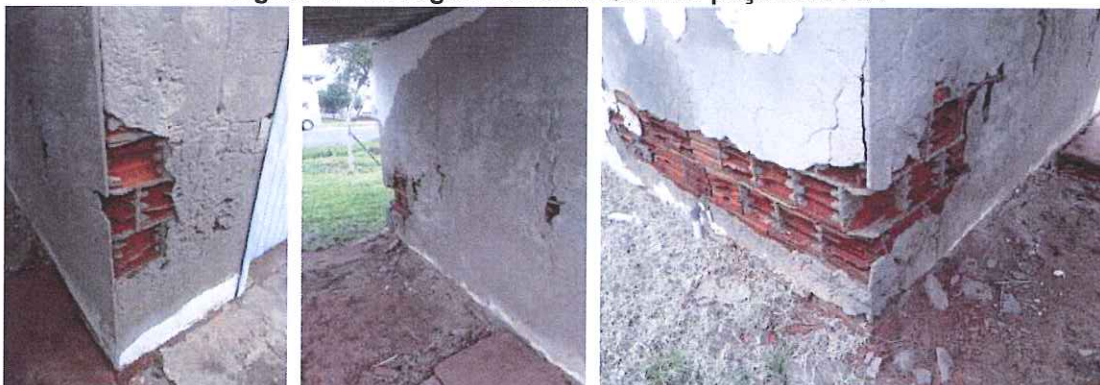
Figura 5: Patologias Casa de Química poço IGR-01A
