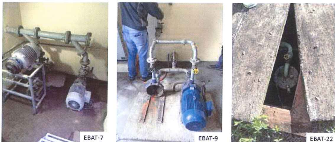
Figura 8: Estações de bombeamento visitadas durante a fiscalização
