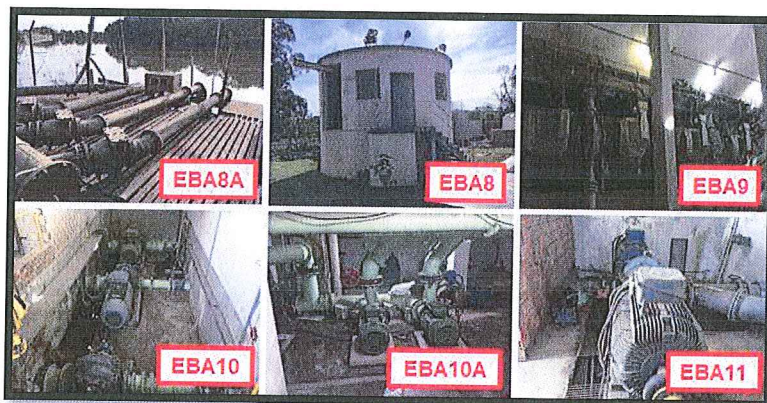
Figura 18: Vista das Estações de Bombeamento
