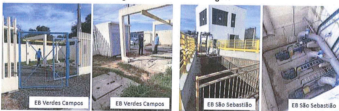
Figura 14: Elevatórias de esgoto
