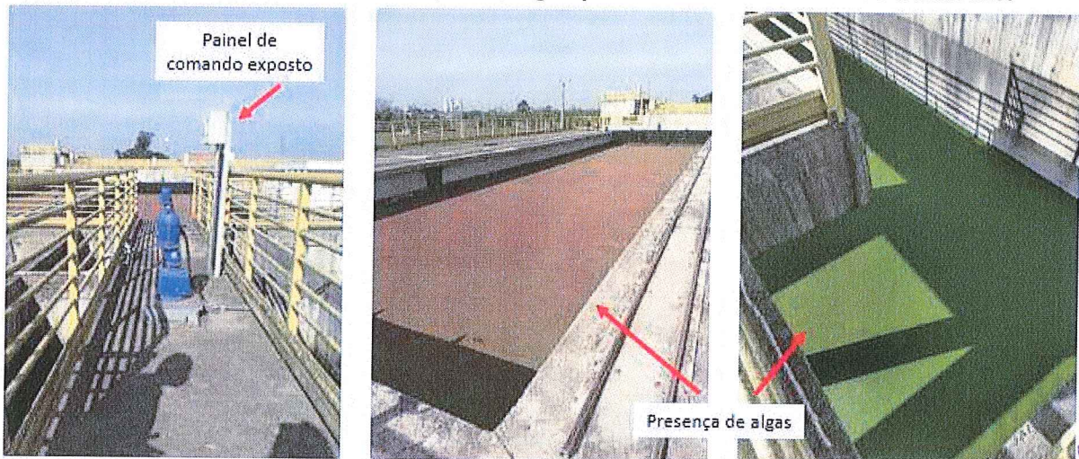
Figura 5: Painel de comando exposto; algas presentes nas unidades de tratamento
