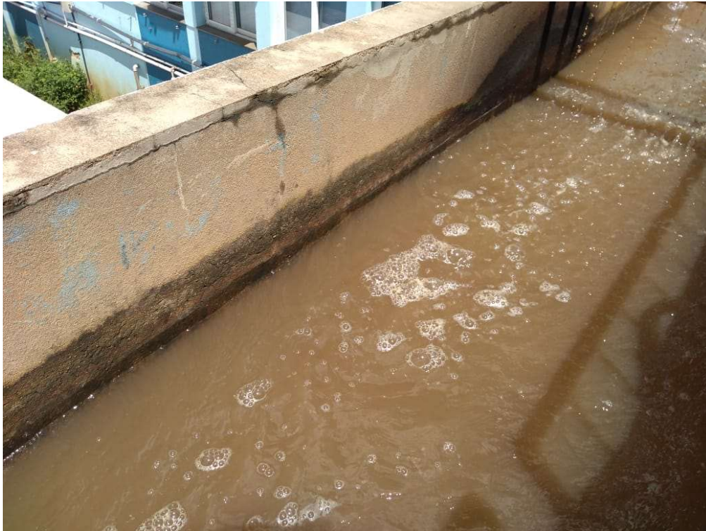
Figura 1. Unidades de tratamento de água do bloco hidráulico após procedimento de limpeza. Posição I.
