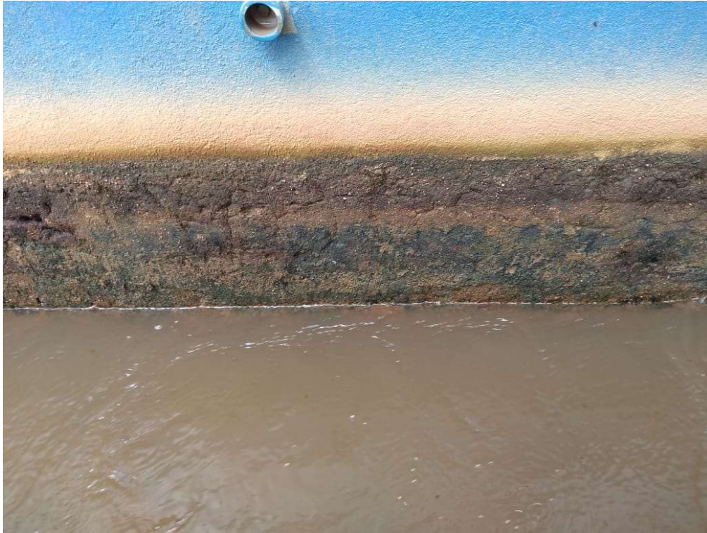
Figura 4. Unidades de tratamento de água do bloco hidráulico após procedimento de limpeza. Posição IV.
