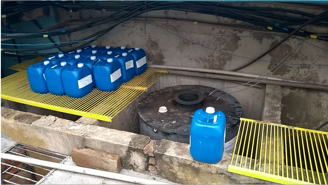
Figura 3. Instalação e ativação do sistema de ortopolifosfato em novo local contendo bacia de contenção e cobertura. Apenas a presença de um estoque mínimo de bombonas para reposição de produto durante o período. Mesmo sendo as bombonas azuis confeccionadas em metrial plástico quimicamente compatível ao produto armazenado, com tampa rosqueável, estanque, essas bombonas estão em local com cobertura e sobre bacia de contenção.
