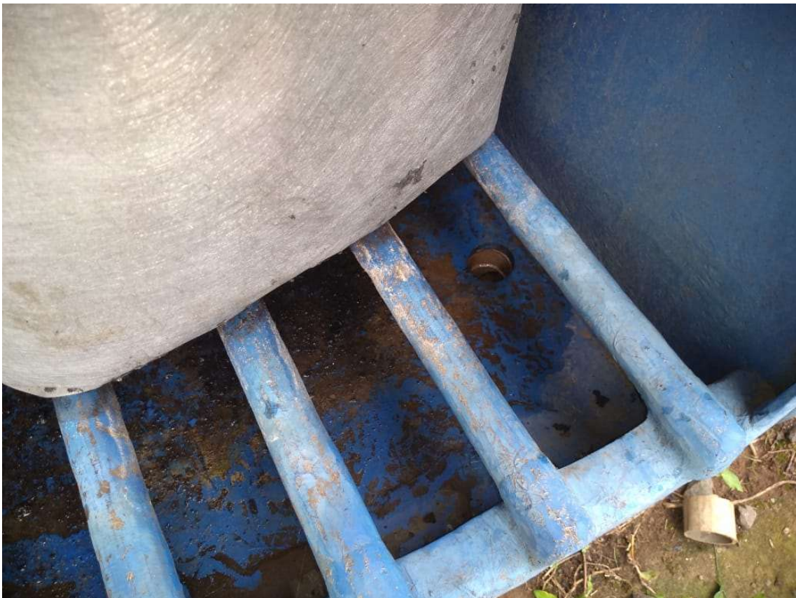
Figura 4. Sistema de drenagem do tipo bags para lodo desobstruído. Posição IV.
