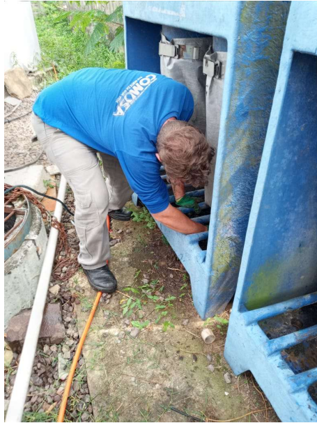
Figura 1. Sistema de drenagem do tipo bags para lodo desobstruído. Posição I.
