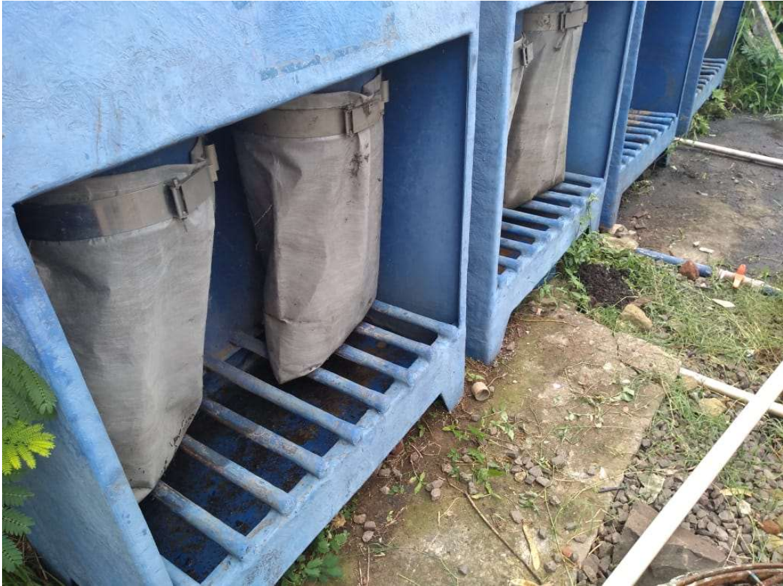
Figura 3. Sistema de drenagem do tipo bags para lodo desobstruído. Posição III.
