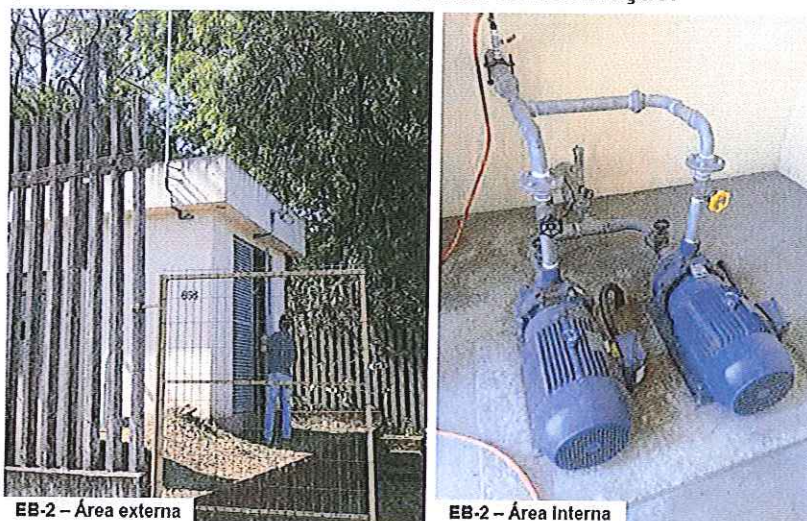
Figura 02: Estação de bombeamento visitada durante a fiscalização.
