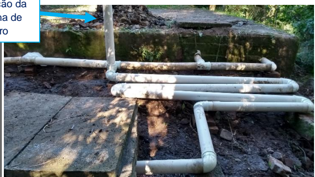
Foto 4. Tubulação para desinfecção
