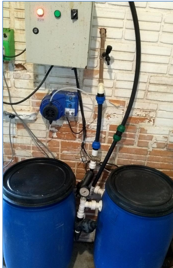
Foto 7. Sistema neutralizador de odores.
