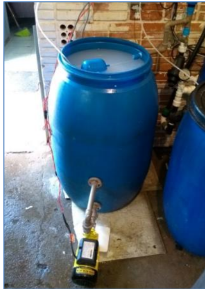
Foto 11. Sistema dosagem antiespumante.
