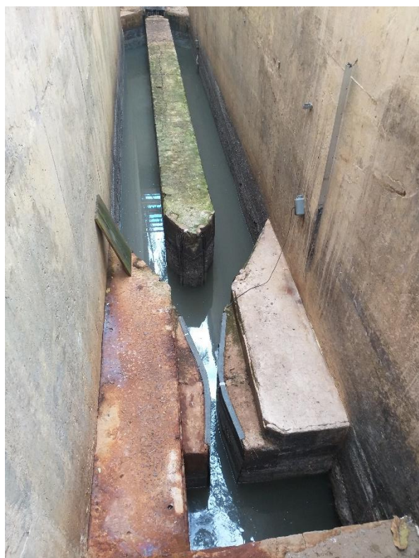
Figura 17. Canais desarenadores e Calha Parshall.
