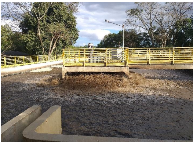
Figura 19. Tanque de aeração.
