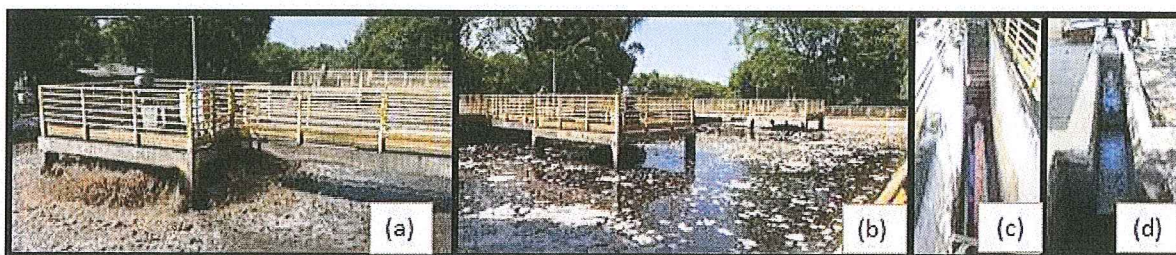
Figura 2: Registro fotográfico da fiscalização à ETE Cohab de Sapucaia do Sul, onde: (a) vista lodos ativados; (b) tanques; (c) desarenador e (d) calha Parshall.
