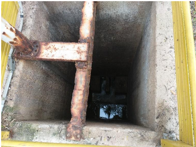
Figura 15. Entrada do esgoto bruto.
