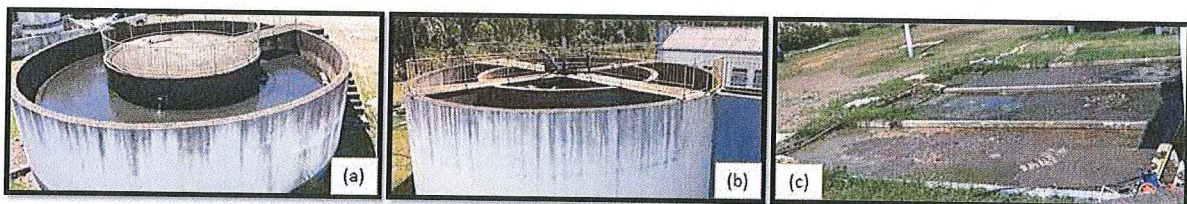
Figura 4: Registro fotográfico da fiscalização à ETE Moradas dos Eucaliptos, onde: (a) vista do bloco 3: Reator de Lodos Ativados; (b) Vista do bloco 2: Reator Anóxico e (c) Leitões de secagem.
