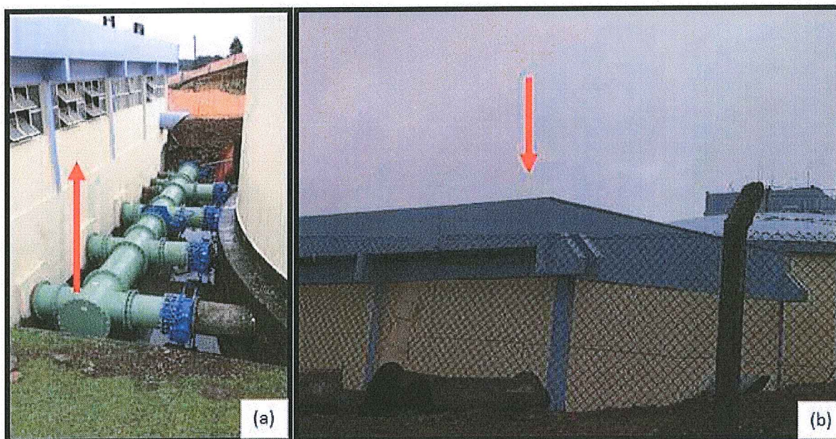
Figura 5: (a,b) Elevatória de água tratada EBAT-2 localizada junto à ETA – II.
