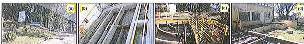
Figura 5: Registro fotográfico da fiscalização à ETA, onde: (a) placa padrão Fepam colocada na entrada do empreendimento; (b-d) partes do bloco hidráulico.
