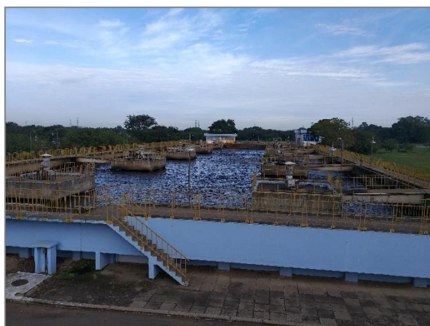
Figura 24. Tanque de aeração.
