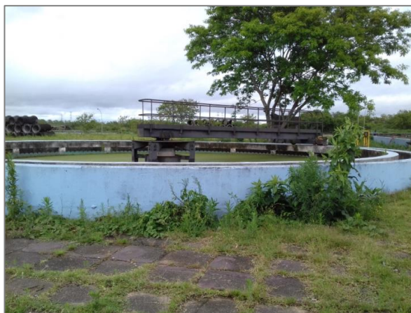
Figura 28. Adensador de lodo.
