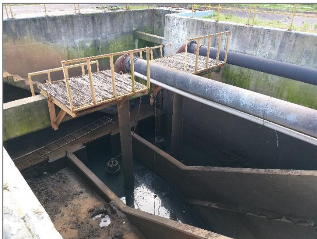
Figura 21. Câmara de chegada do afluente
