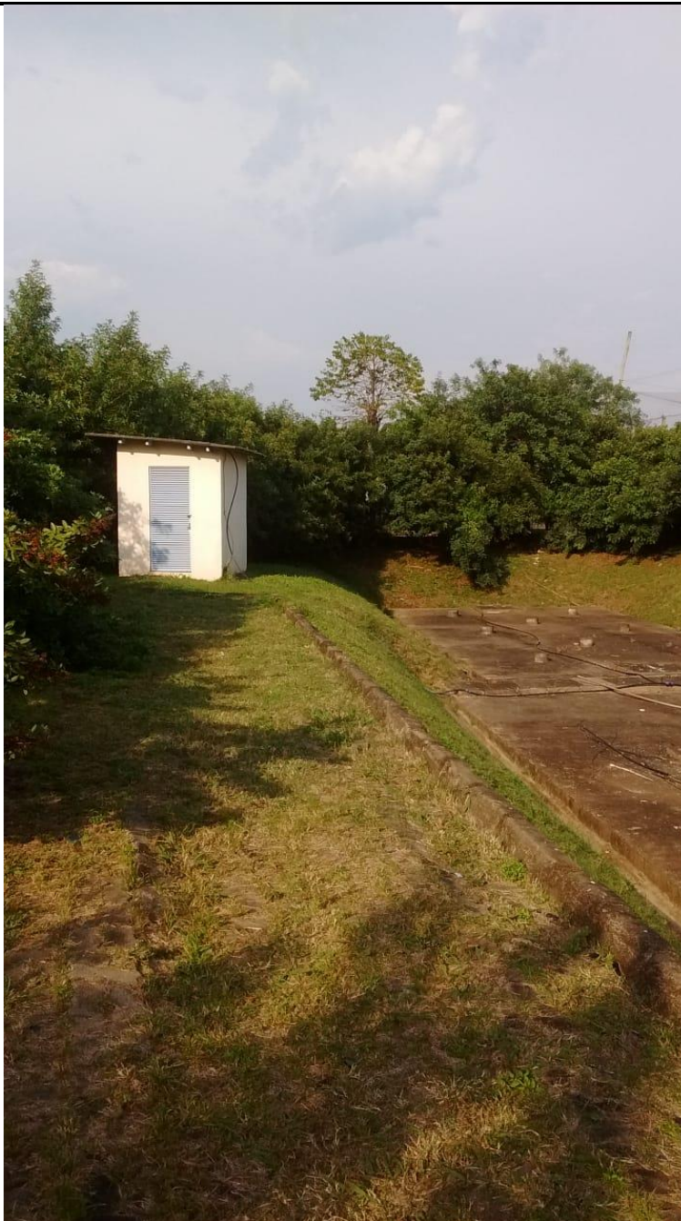
Figura 8: Vista da ETE com o abrigo do sistema de neutralização de odores.
