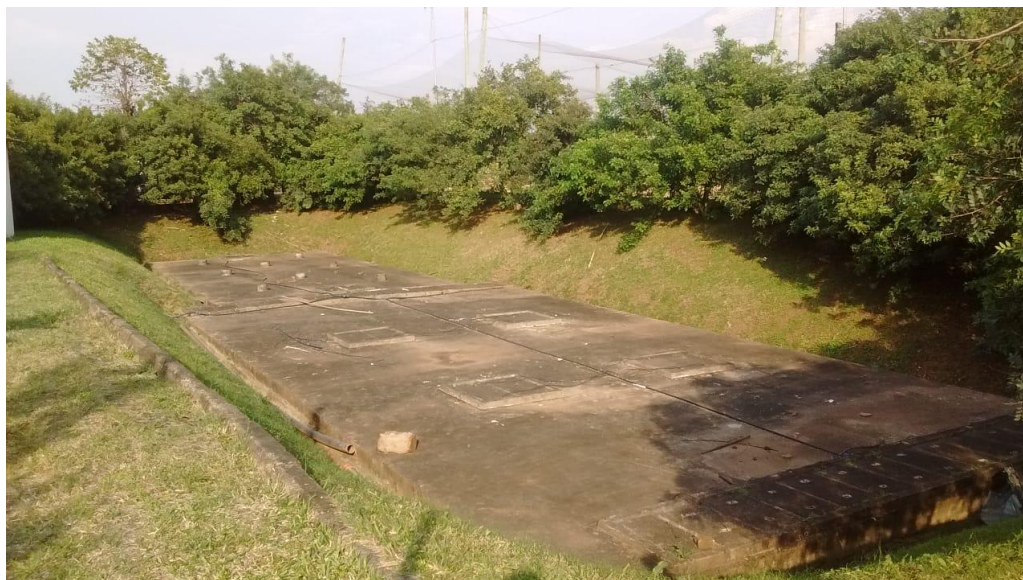
Figura 7: Vista geral da estrutura do filtro biológico e tanque séptico.
