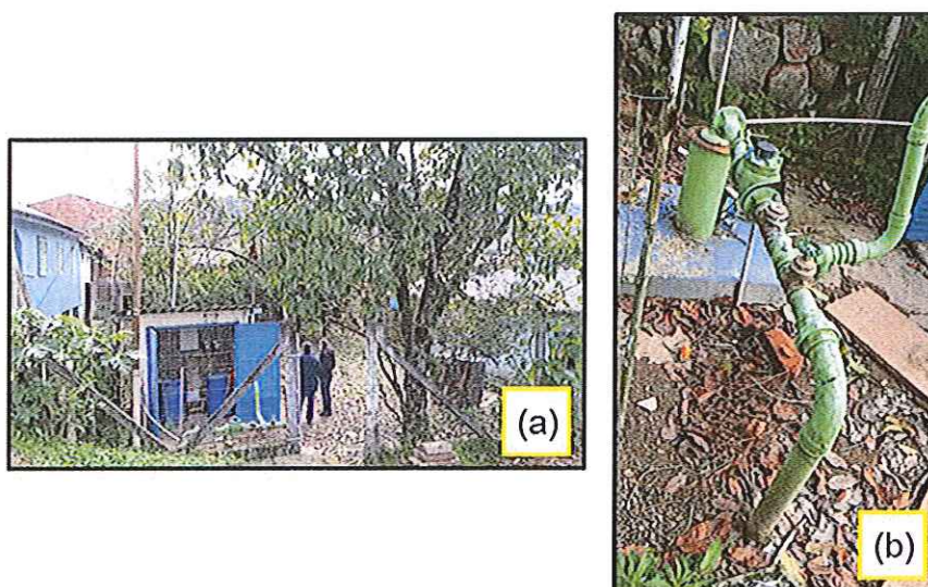
Figura 3: Registro fotográfico do Poço TCO-02, onde: (a) vista frontal, e; (b) captação subterrânea.
