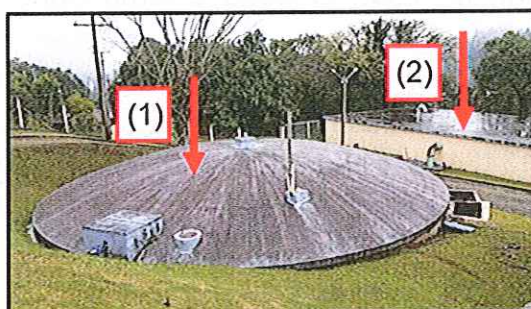
Figura 4: Reservatórios localizados junto à ETA, onde (1) Reservatório 01 de 500 m 3 , e; (2) reservatório 01A de 1000 m 3 .
