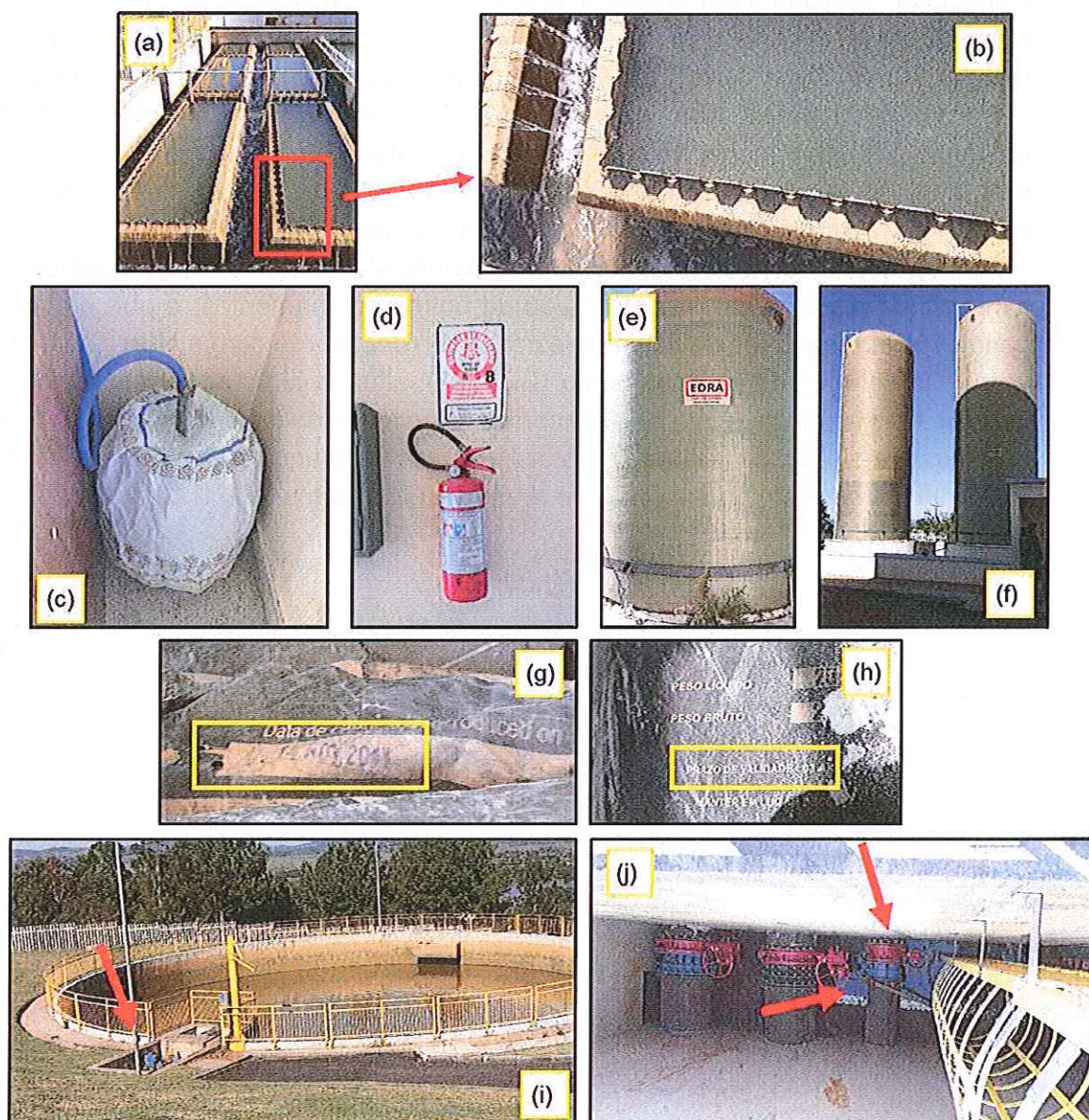
Figura 3: Registro fotográfico executado na ETA, onde: (a-b) existência de flocos nos filtros; (c) botijão de gás localizado na copa; (d) hidrante com identificação feita em folha de papel; (e-f) tanques para o armazenamento de produtos químicos sem identificação; (g-h) produto químico vencido; (i) inexistência de grelha sobre câmara de registros de manobra, e; (j) vazamento aparente próximo à reservação da ETA.
