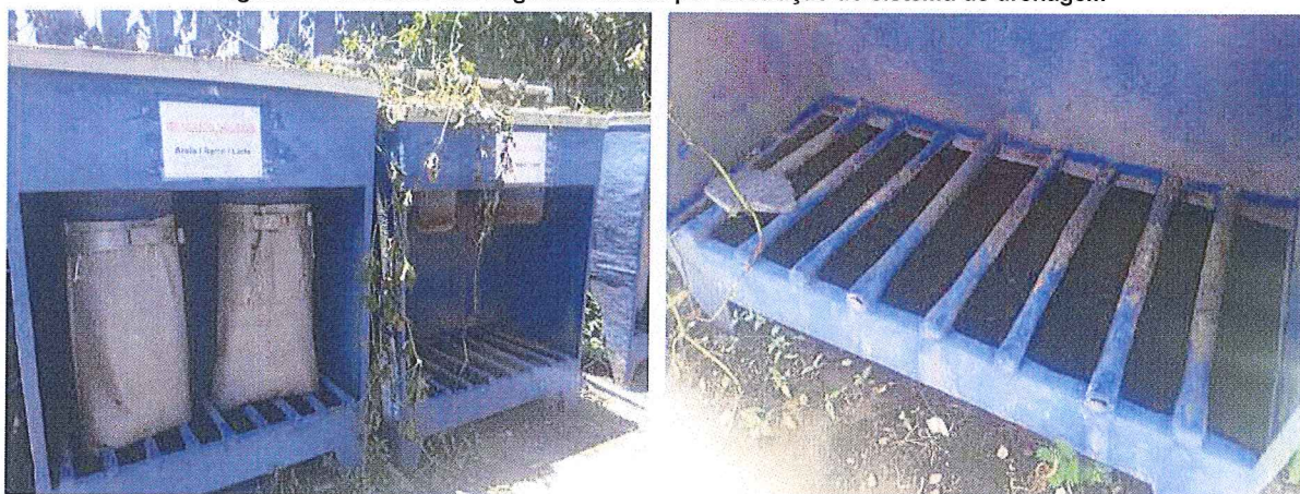
Figura 2: Percolado dos bags acumulado por obstrução do sistema de drenagem
