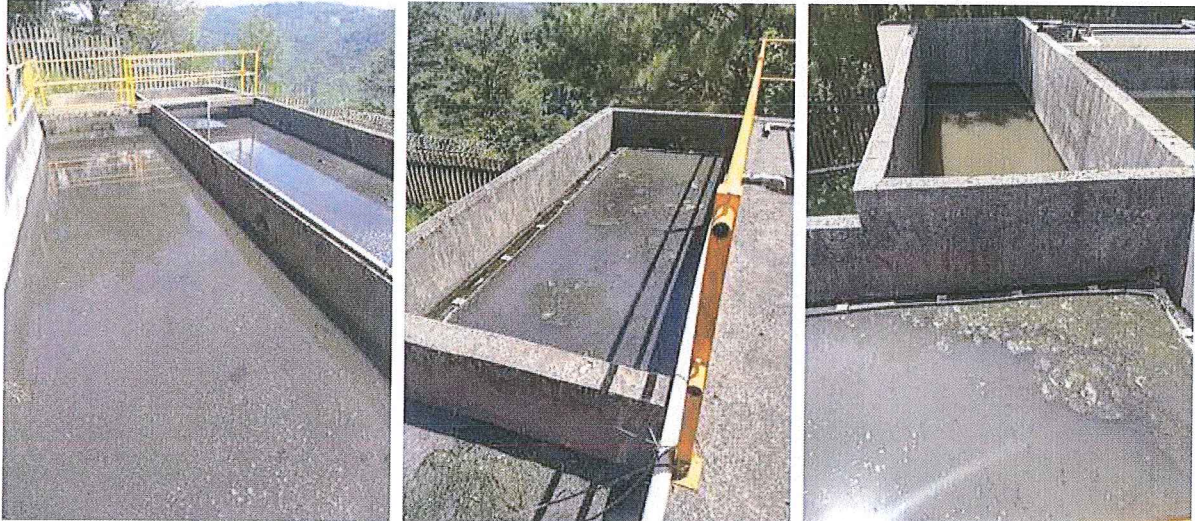
Figura 14: Aspecto do efluente ao longo do tratamento na ETE Reserva da Serra
