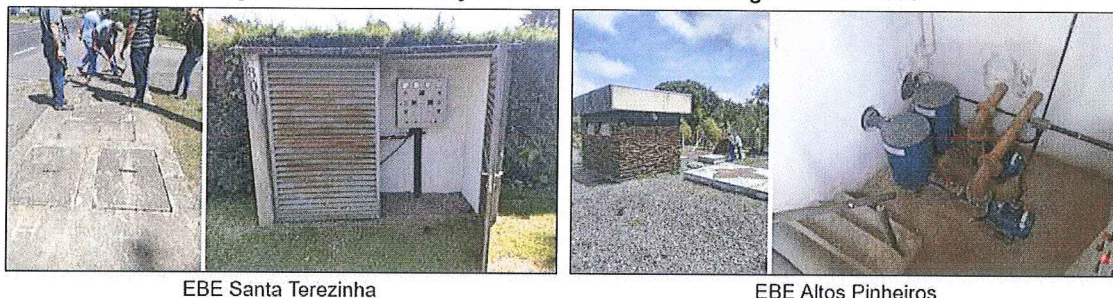
Figura 8: Vista das Estações de Bombeamento de Esgoto fiscalizadas
