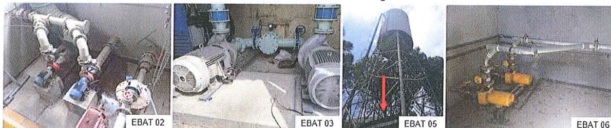
Figura 6: Vista das Estação de Bombeamento de Água Tratada fiscalizadas
