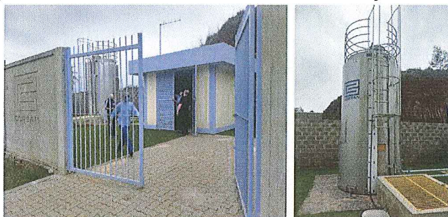
Figura 4: Vista do reservatório fiscalizado sem identificação no Anexo II
