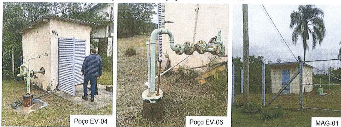
Figura 1: Vista dos poços de Estância Velha
