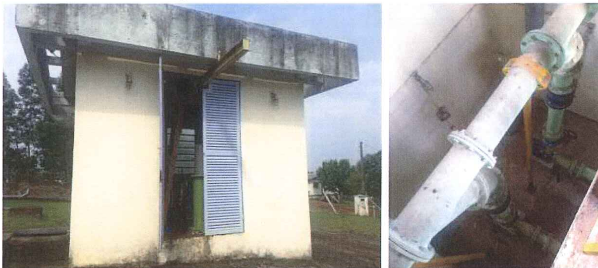
Figura 1: Vista da Estação de Bombeamento EBAT-2
