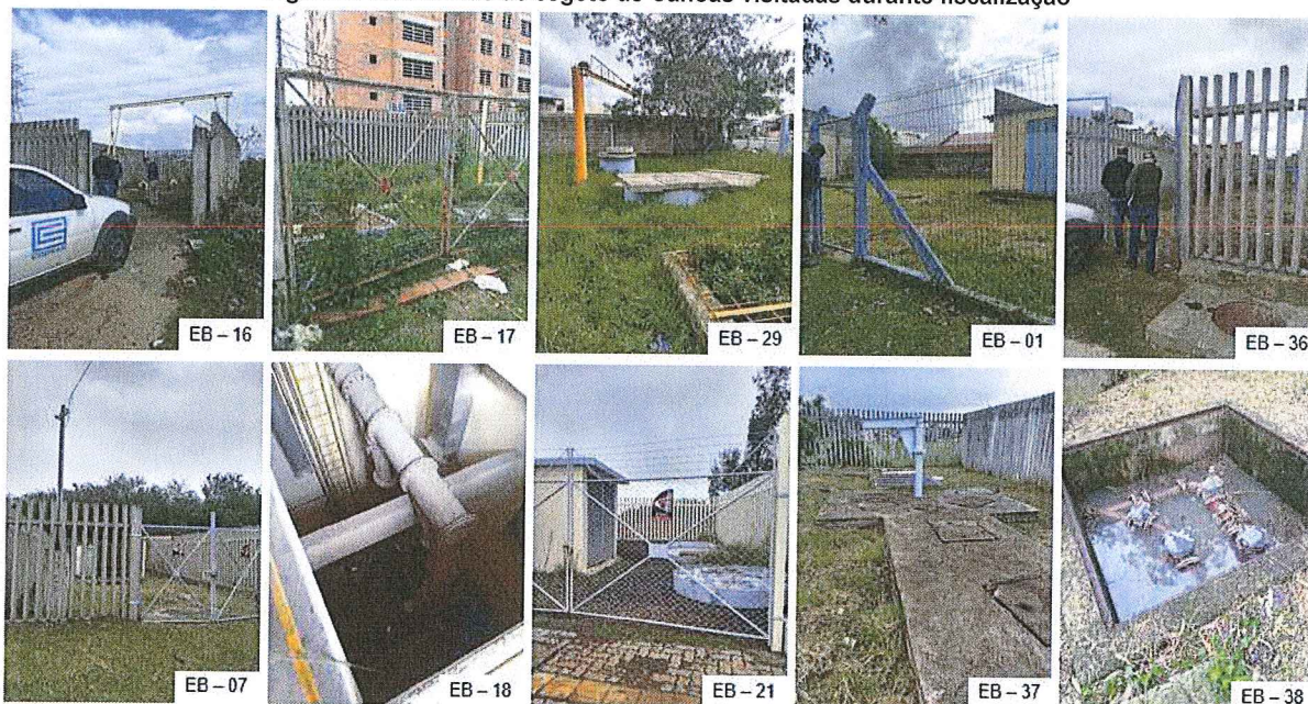
Figura 4: Elevatórias de esgoto de Canoas visitadas durante fiscalização
