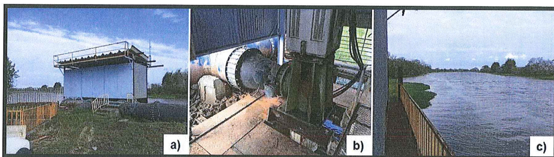
Figura 7: Sistema de Captação de Água Bruta. a) Vista da casa de bombas; b) Vista da bomba de captação; c) Vista do manancial do Rio Jacuí
