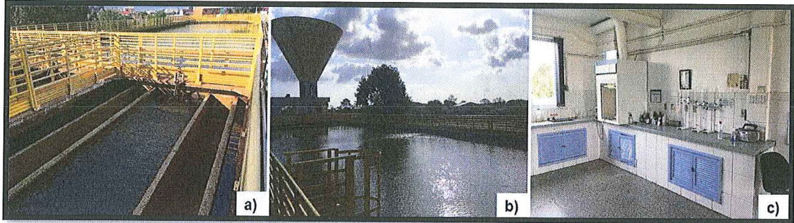
Figura 9: Estação de Tratamento de Água Niterói. a) Vista do filtro; b) Vista do tanque de decantação; c) Vista do laboratório da ETA
