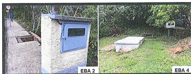
Figura 8: Vista das Estações de Bombeamento
