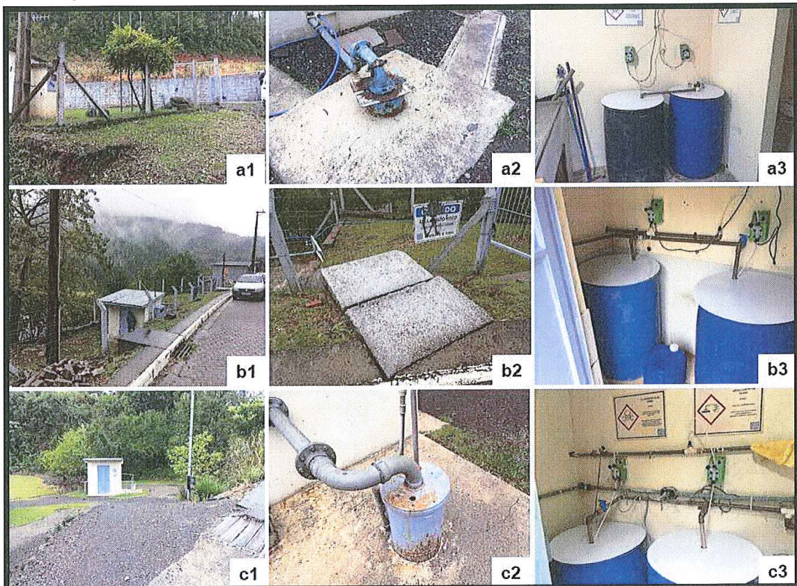
Figura 4: Poços 1, 2 e 8. a1) Vista da área do poço 1; a2) Ponto de captação do poço 1; a3) Vista do armazenamento de químicos para o tratamento do poço 1; b1) Vista da área do poço; b2) Ponto de captação do poço; b3) Vista do armazenamento de químicos para o tratamento do poço 2; c1) Vista da área do poço; c2) Ponto de captação do poço; c3) Vista do armazenamento de químicos para o tratamento de poço 8
