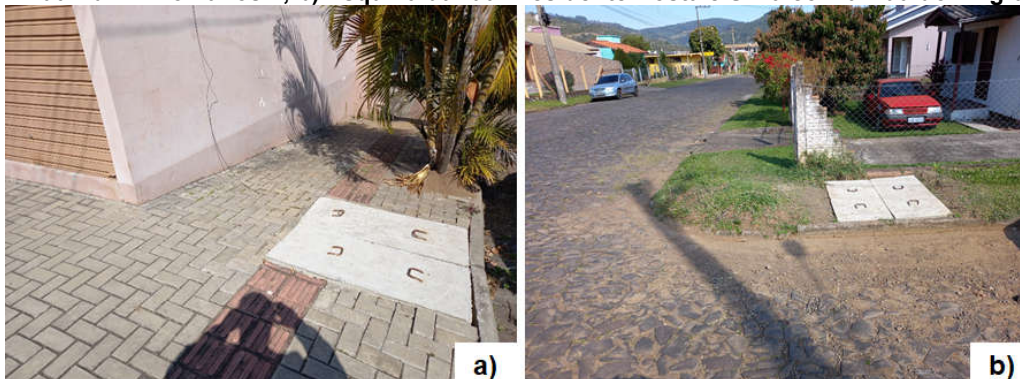
Figura 12 - Registros fotográficos do local de instalação dos VRPs. A) Esquina da rua Presidente Costa e Silva com rua Edwin Korzanoski; b) Esquina da rua Presidente Costa e Silva com a Rua do Imigrante.
