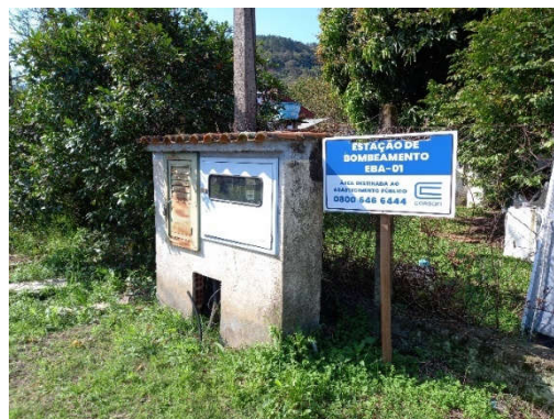
Figura 16 – Registro fotográfico do local de instalação do booster da esquina da rua Presidente Costa e Silva com a rua do Imigrante.
