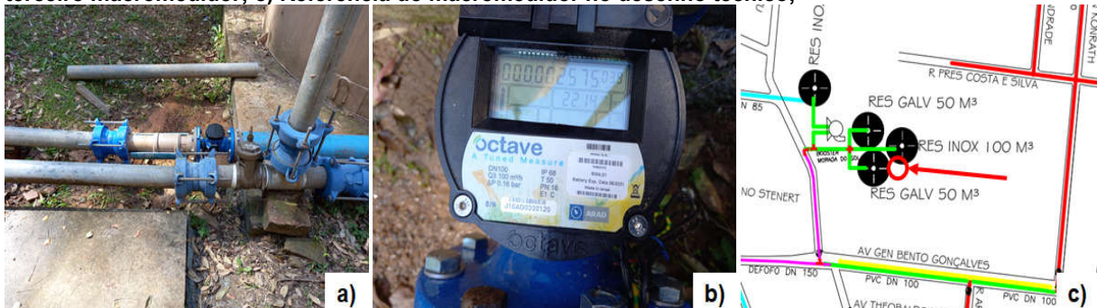
Figura 5 – Macromedidor da saída do reservatório. a) Local de instalação do macromedidor; b) Vista do terceiro macromedidor; c) Referência do macromedidor no desenho técnico;
