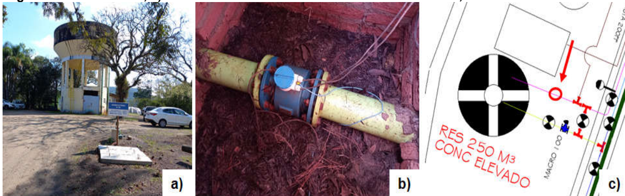
Figura 4 – Macromedidor da saída do reservatório R2. a) Localização do macromedidor na ETA; b) Vista do segundo macromedidor; c) Referência do macro medidor no desenho técnico;
