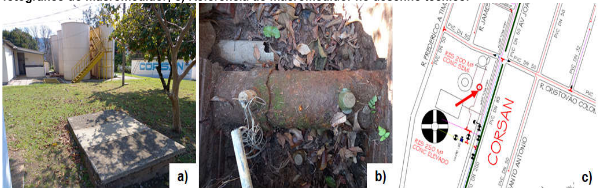
Figura 3 – Macromedidor da saída da EAT da ETA. a) Localização do macromedidor na ETA; b) Registro fotográfico do macromedidor; c) Referência do macromedidor no desenho técnico.
