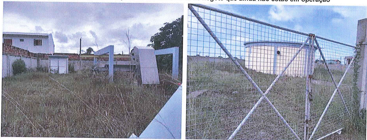
Figura 18: Vista das Estações de Bombeamento de Esgoto que ainda não estão em operação
