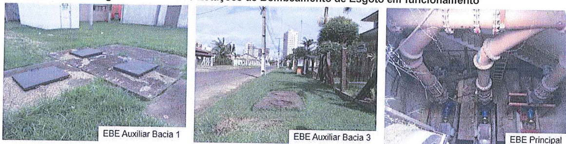
Figura 17: Vista das Estações de Bombeamento de Esgoto em funcionamento
